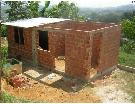
mit unserer Unterstützung ermöglichter Zubau
